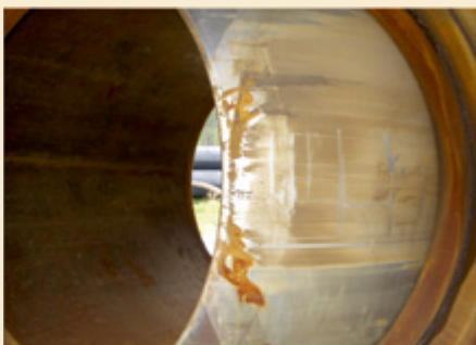
Эрозионный износ шара, ставший причиной вырезки крана большого диаметра
